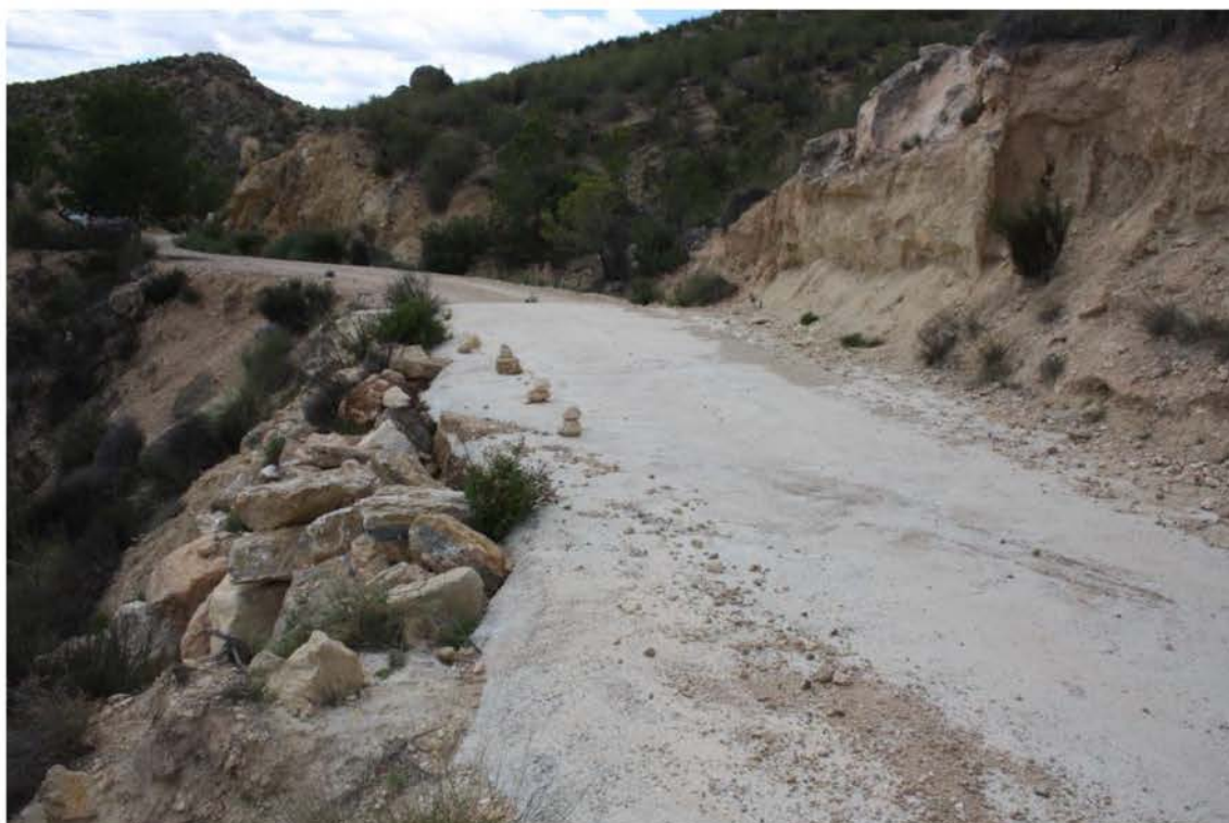
Foto 6: Situación actual del badén de hormigón.
